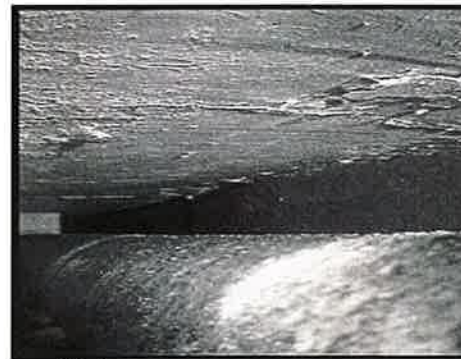
État des dalles supérieures
