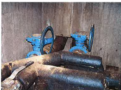
Chambre de vannes
